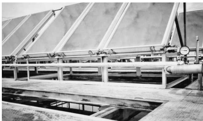
Рис. 1. Гелиоустановка горячего водоснабжения СГУ
