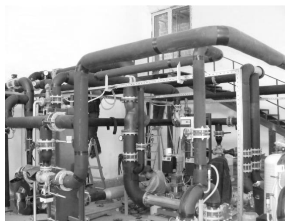
Рис. 5. Оборудование геотермального центрального теплового пункта в пос. Розовом, Лабинского района, Краснодарского края.
